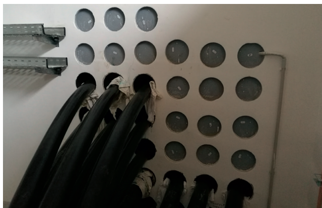
Vgrajenih 39 uvodnice ZVR 150/300
